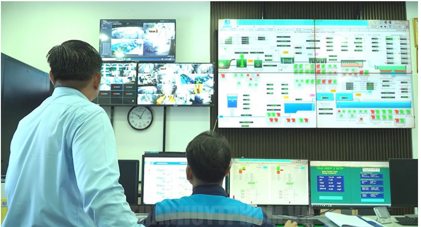
Tổng Công ty Cấp nước Sài Gòn đưa vào sử dụng Trung tâm Dữ liệu (Data Center)
