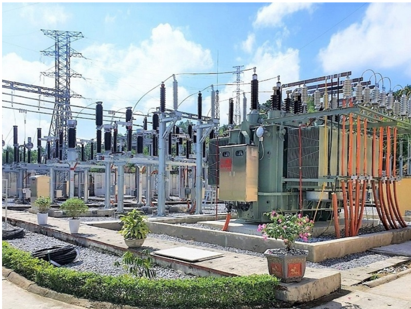
Trạm biến áp 110kV Tĩnh Gia 2, PC Thanh Hóa điều khiển xa không cần người trực
