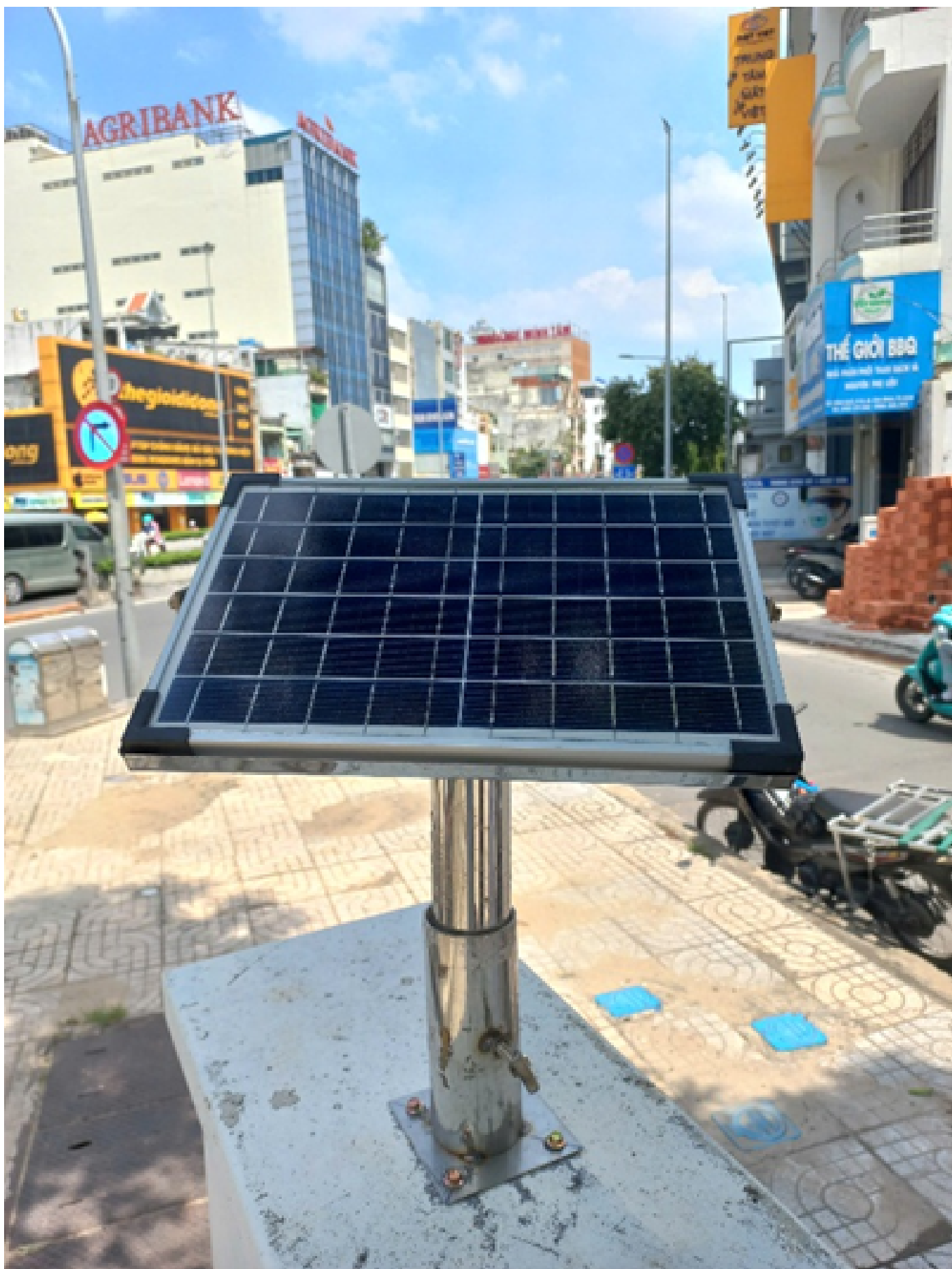
Tấm Solar gắn tại quận Tân Bình
