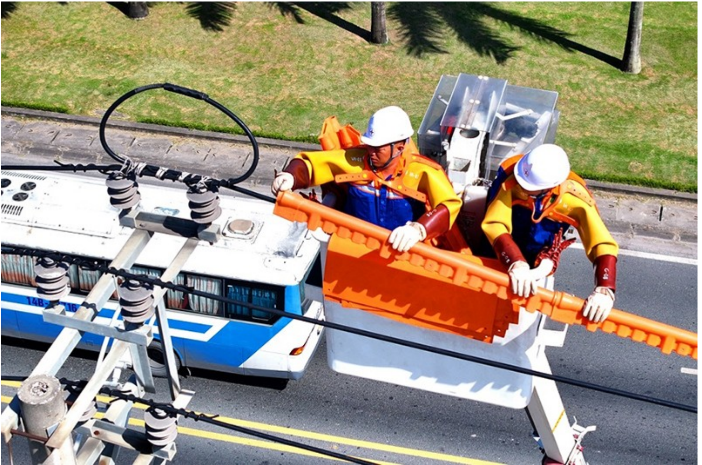
Điện lực Quảng Ninh sửa chữa, đấu nối hotline theo yêu cầu của khách hàng.
