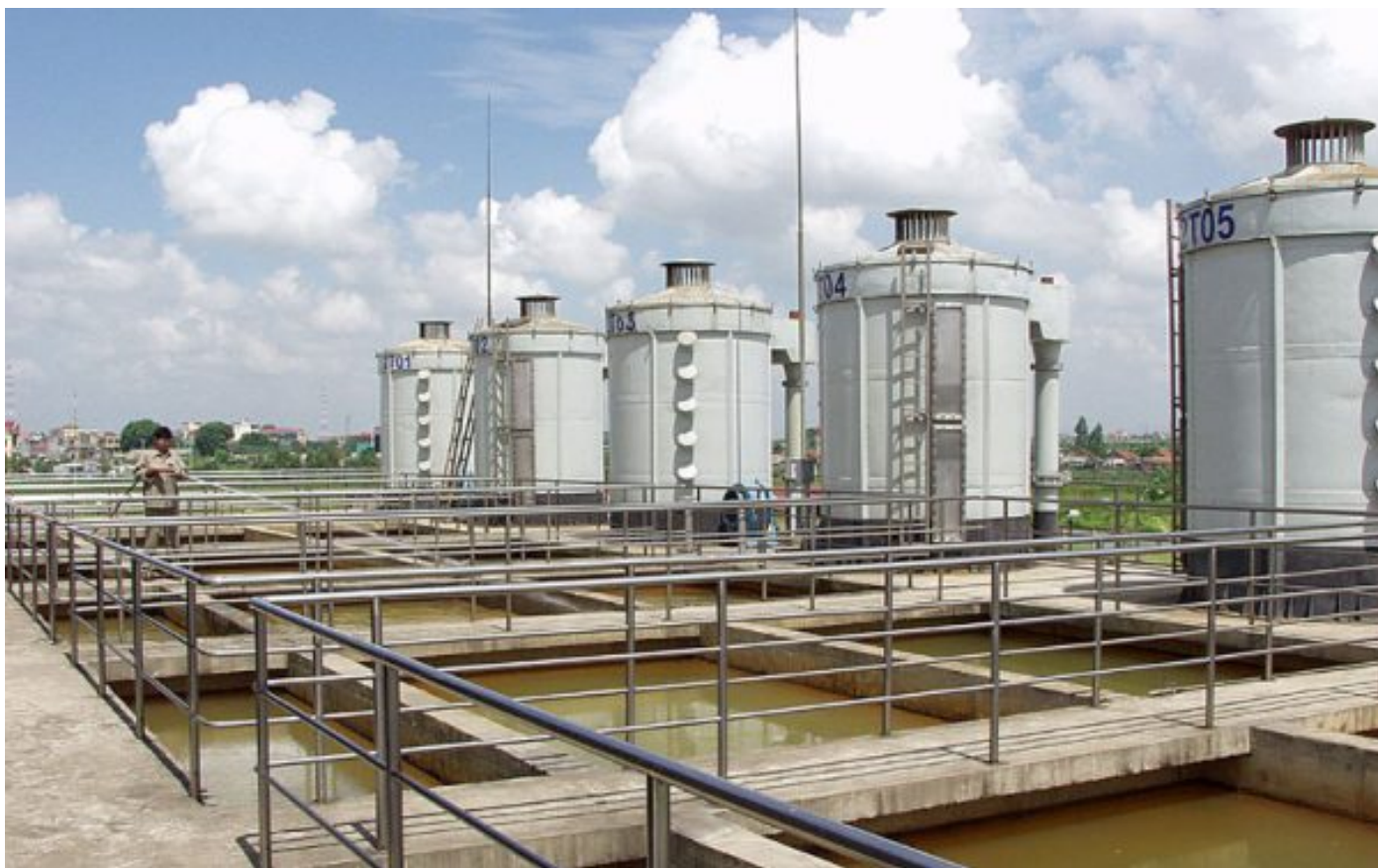
Hệ thống xử lý nước sinh hoạt 30m 3 /giờ tại nhà máy Bia Sài Gòn - Mê Linh_Ảnh: Đỗ Thảo
