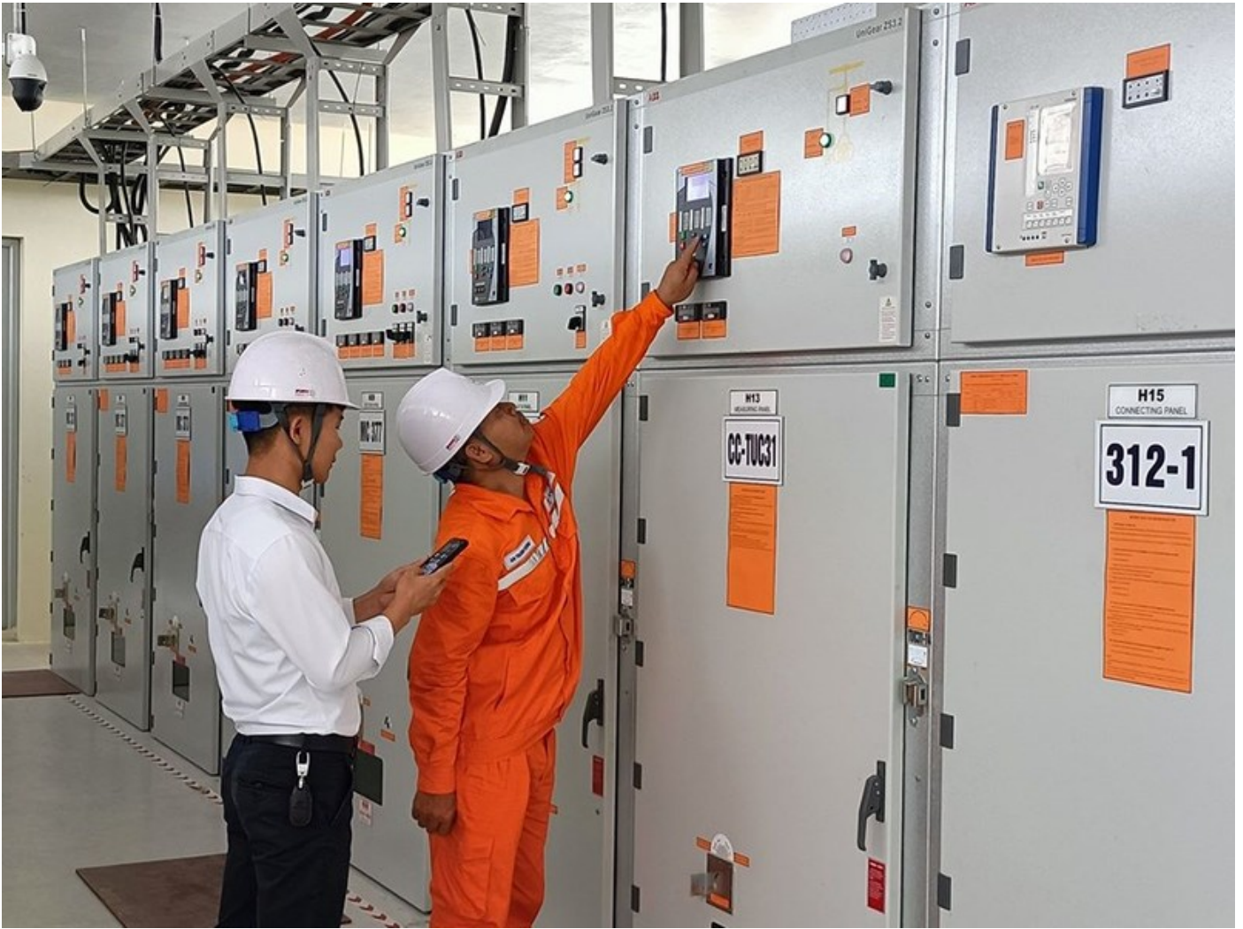
Điện lực Hải Dương kiểm tra hệ thống rơ le kỹ thuật số đường dây 22kV.
