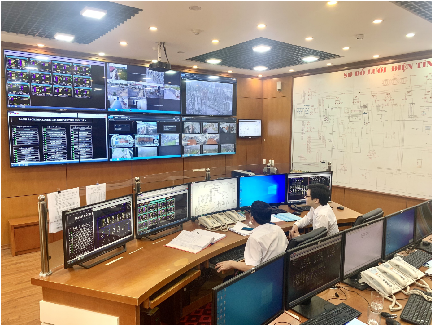
Trung tâm điều khiển xa Công ty Điện lực Thái Nguyên
